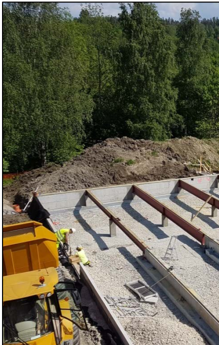
Foto 1. Ringmur med ståldragere (Asker kommune)
