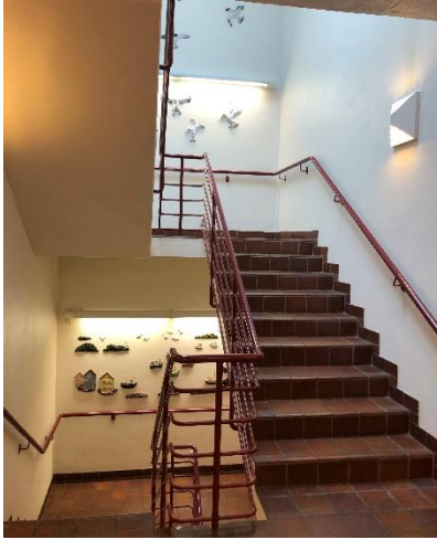
Opprinnelig rekkverk – ikke ihht. TEK'en
