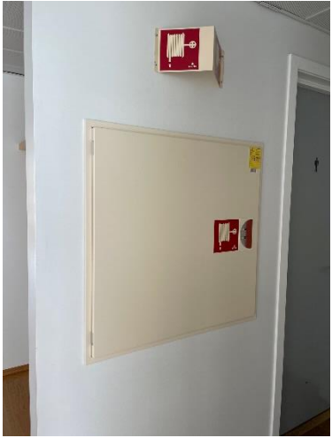
Brannskap i opprinnelig bygg på Skøyen
