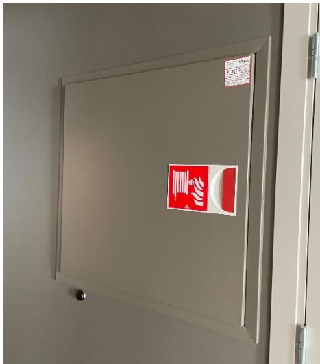
Ombrukte brannskap på plass
